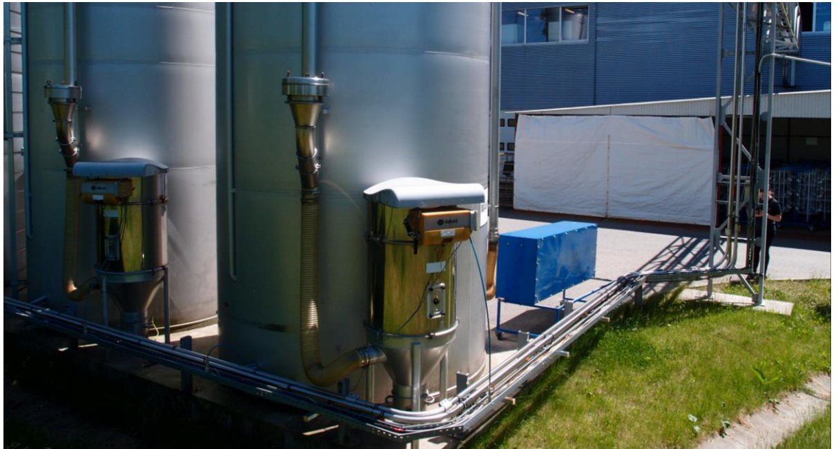
(Obr. č. 1.2.4 – Pneumatické potrubí)
