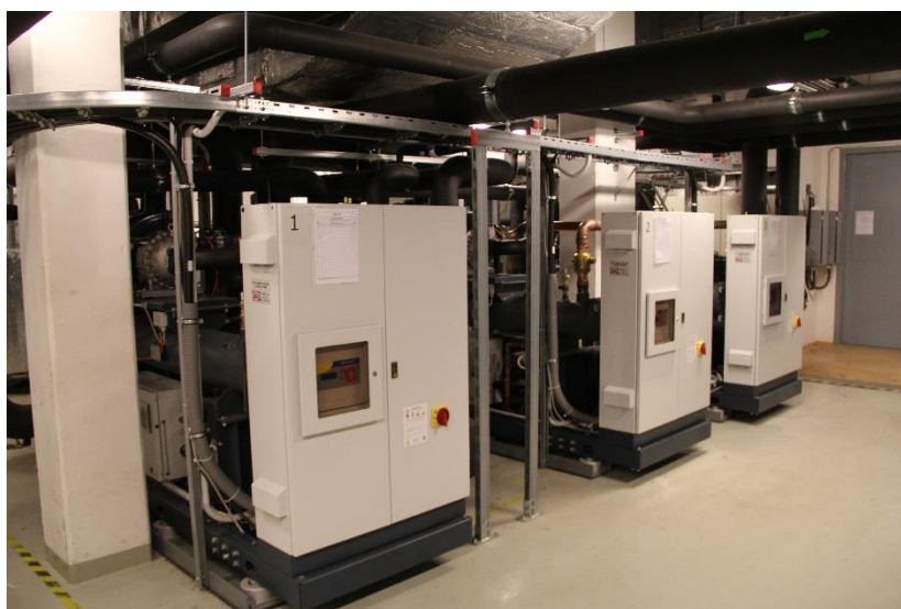
Obr. 4–1 Zdroj chladu 3x Chiller Turbocor
