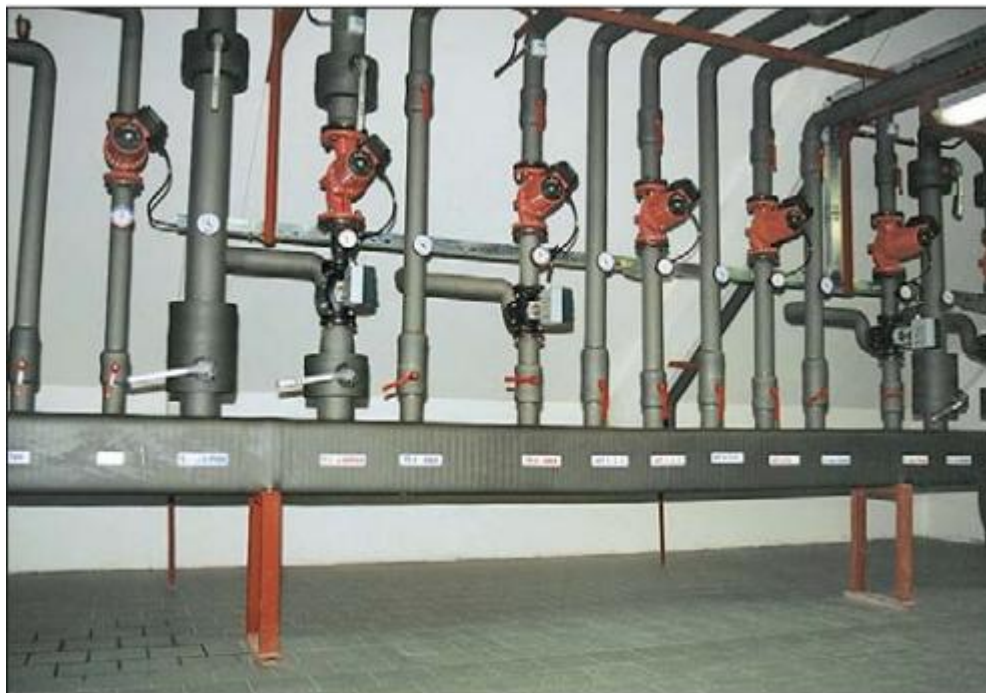
Obr. 4.3 Kombinovaný rozdělovač a sběrač ETL ekotherm – příklad instalace
