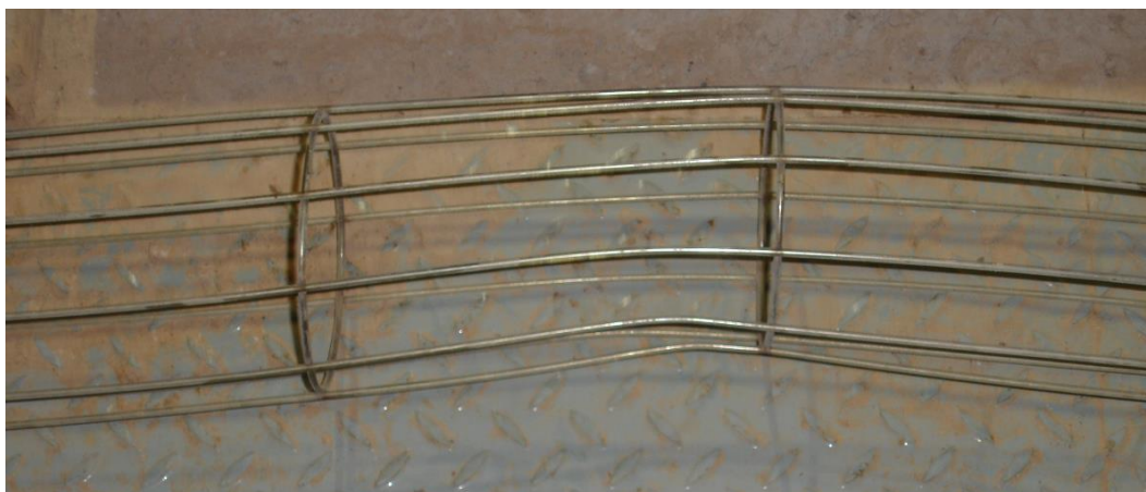
Obr. 27 Zdeformovaná opěrná klec
