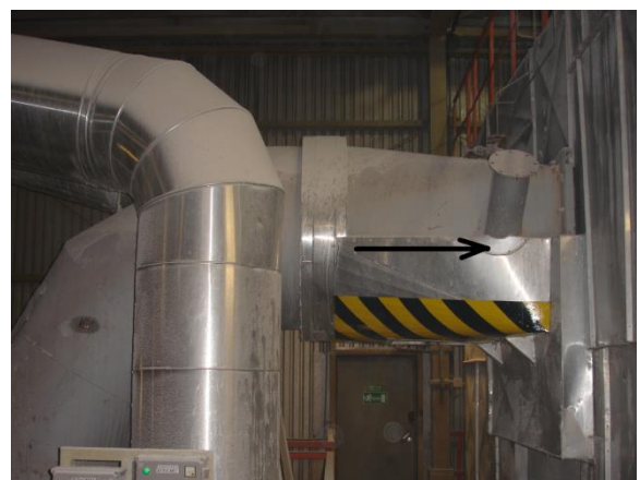
Obr. 11 Vstup znečištění do filtru chladícího okruhu
