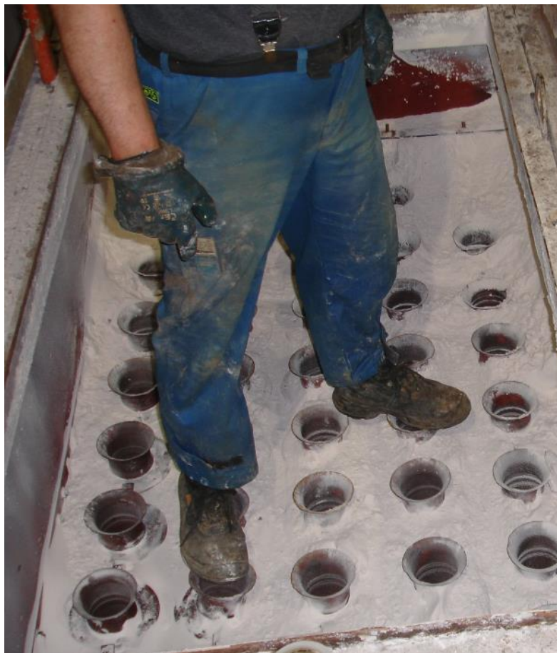
Obr. 29 Znečištěná čistá strana filtru prasklou filtrační hadicí
