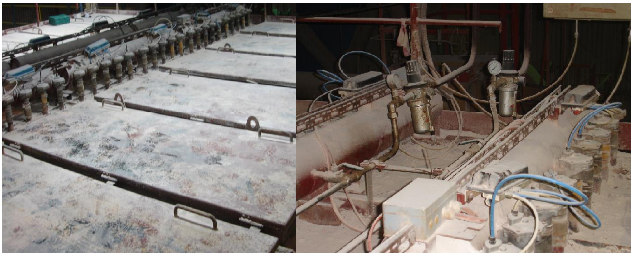
Obr. 22 Rozvod tlakové vzduchu pro regeneraci na střeše filtru
