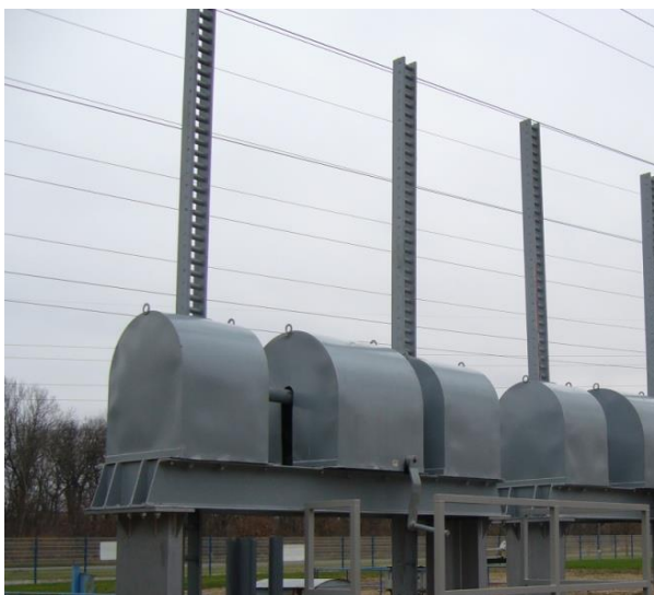
obr. 4.: Cévové tyče mechanismů stavidel vodní elektrárny Mělník [4]
