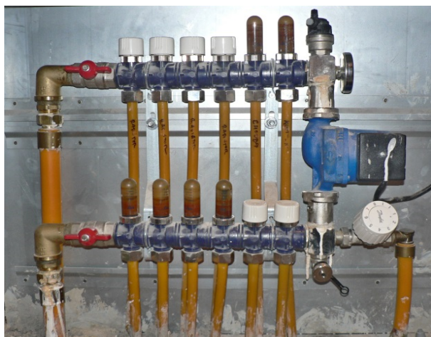
Obr. 7 Rozvaděč systému podlahového vytápění
