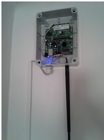
Obrázek 1.6: Fotografie jednoho z instalovaných přístupových bodů s odkrytým víkem.
