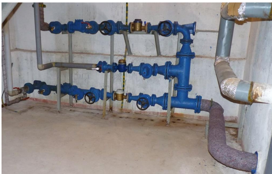
Obrázek 4: Přívod vody do sekce T33, SV - fotografie
