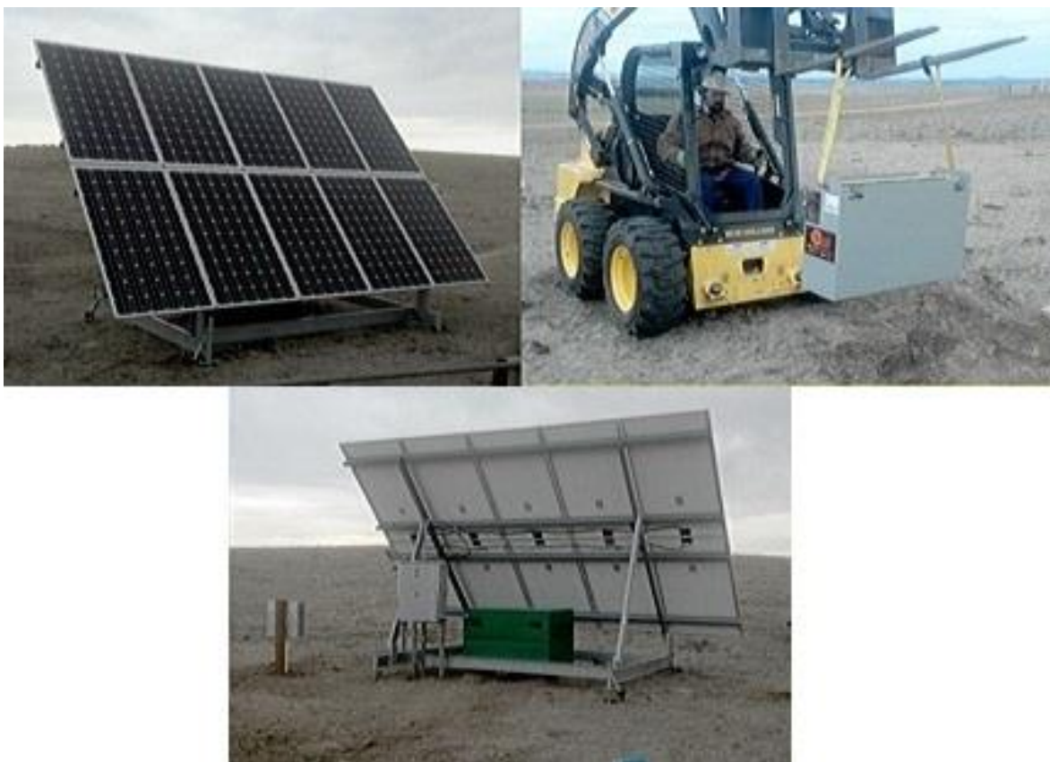
Obrázek 3 – stanice katodové ochrany produktovodů, který využívá sluneční energii [15].
