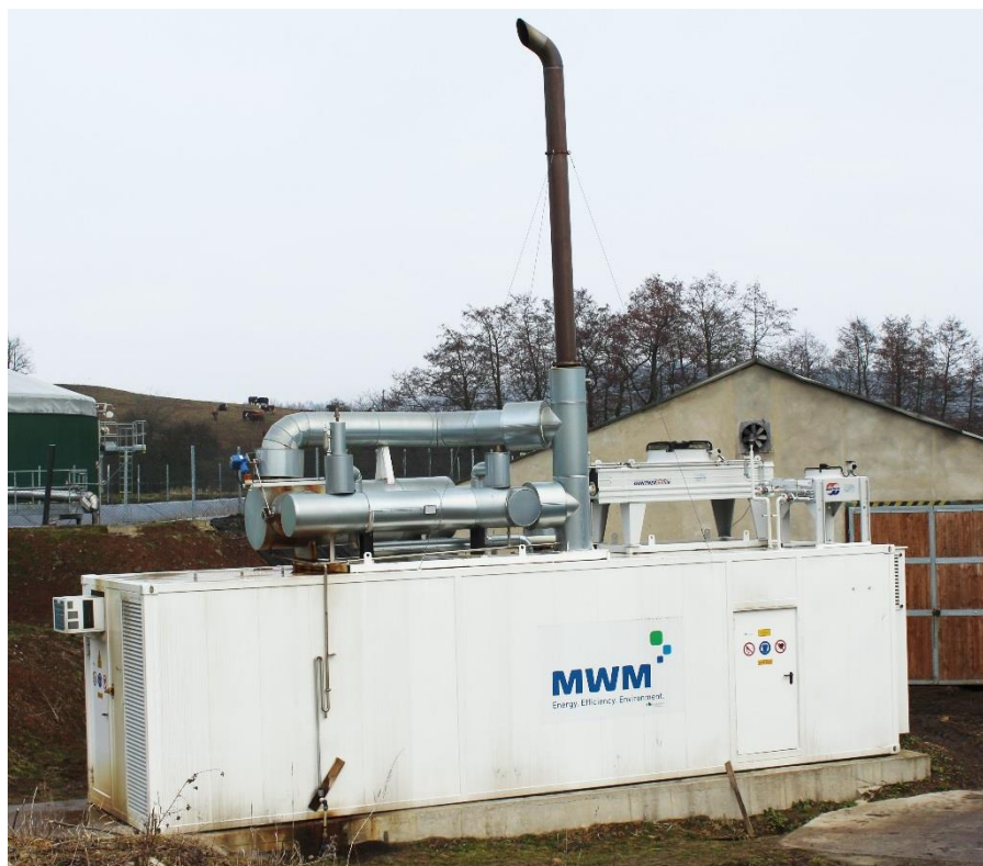
Obrázek 15 : Uložení kogenerační jednotky v BPS Lesná
