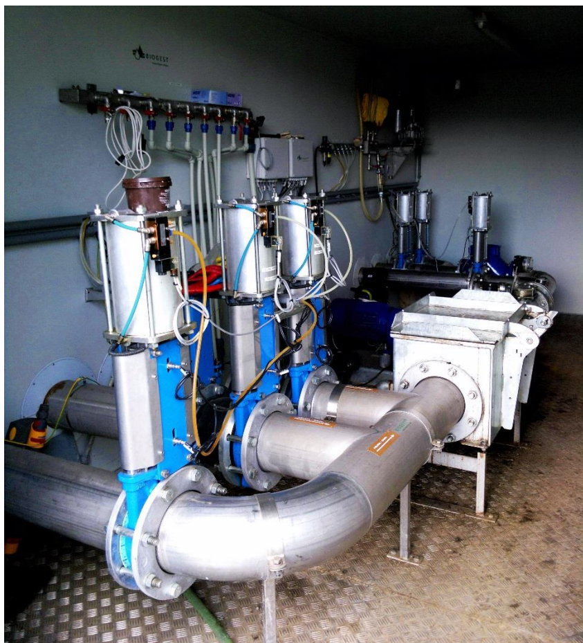
Obrázek 12 : Centrální čerpací stanice
