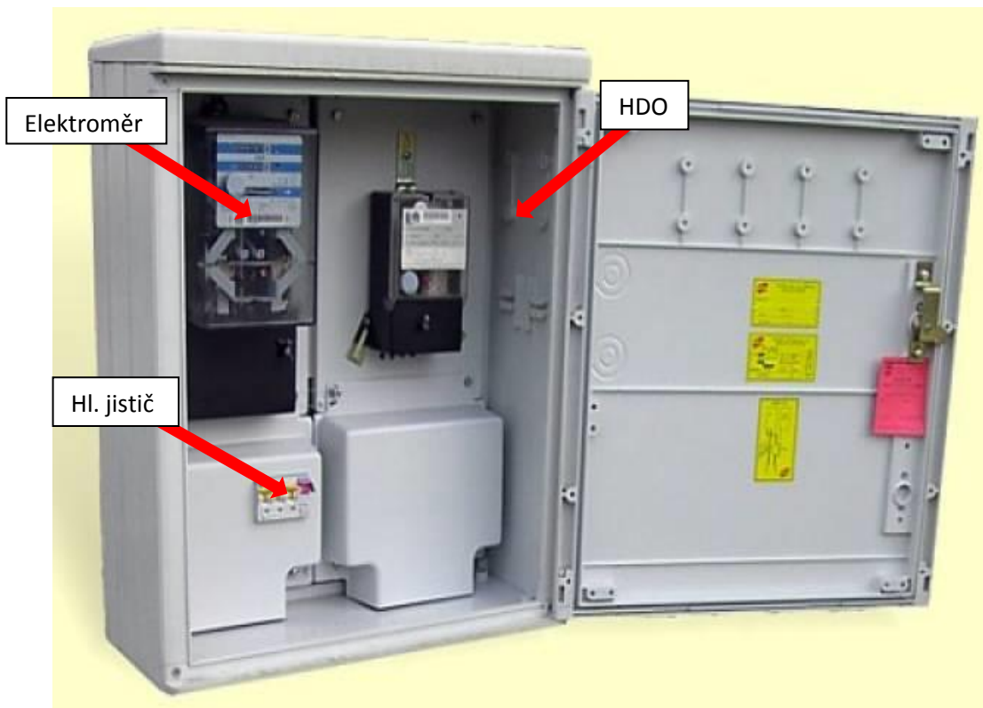
Obr. 4- 1 Elektroměrová skříň a její komponenty [5]
