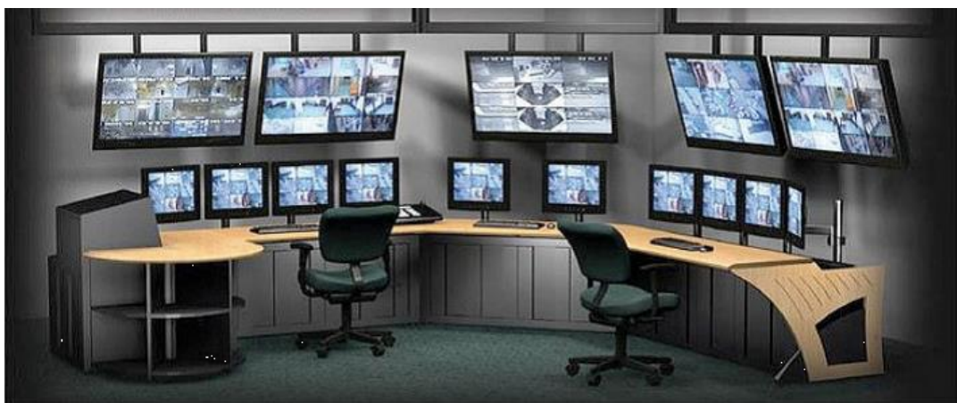
Obr. 1 Ústředna bezpečnostního kamerového systému (3)
