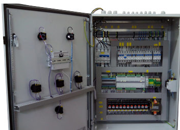
Obrázek 1: Otevřená skříň malého rozváděče 600x800 mm firmy Schrack.
