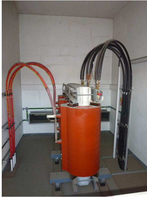
Obr. 13 Příklad provedení trafokomory osazené suchým transformátorem. Transformátor je usazen na ocelových kolejničkách. Vpravo přívodní kabely vn 22 kV. Vlevo vývod kabelů 0,4 kV.
