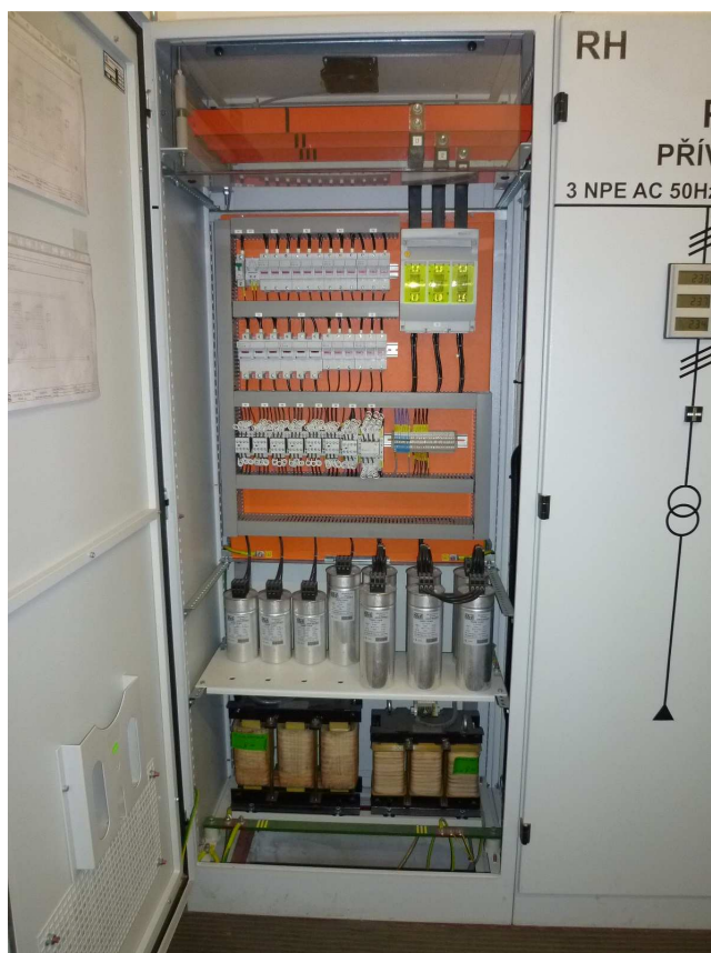
Obr. 22 Rozvaděč kompenzace. Dole induktivní stupně, nad nimi kompenzační stupně (kondenzátory).
