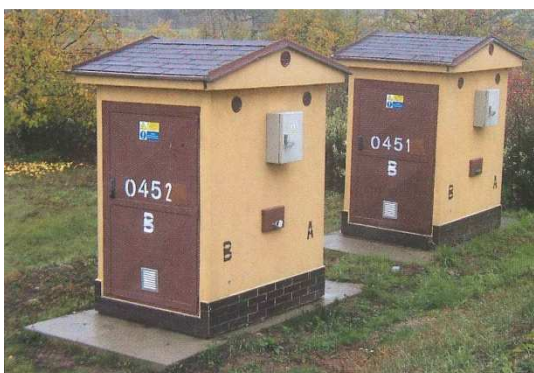
Obr 9 Traťová transformovna 6/0,23 kV, 75 Hz
