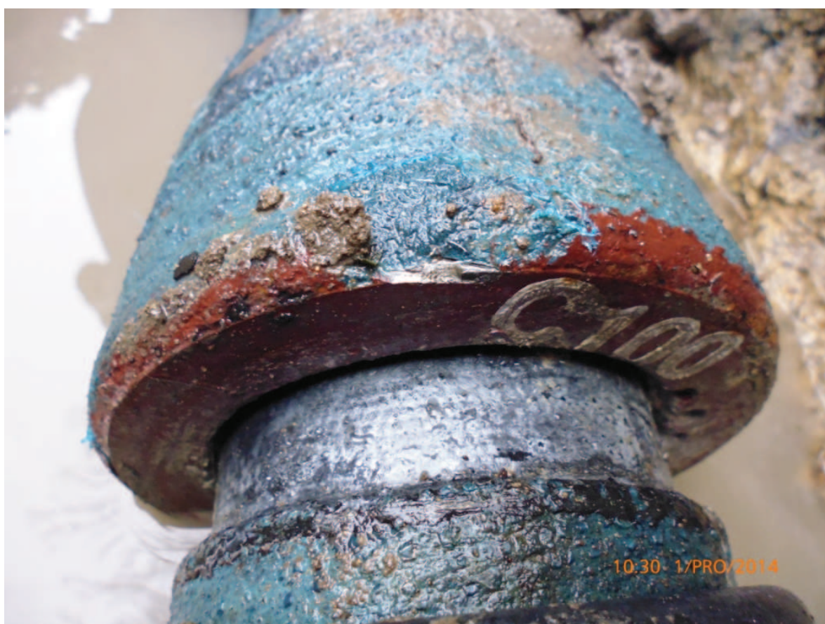
Obrázek 4.19: Detail 2 zobrazení hrdlového spoje chráněného gumového manžetou po roce korozního namáhání
