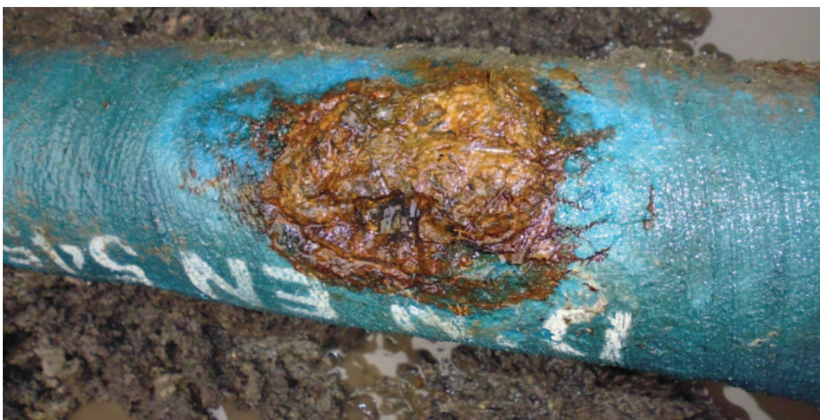
Obrázek 4.20: Zobrazení místa s poškozenou izolací po roce korozního namáhání
