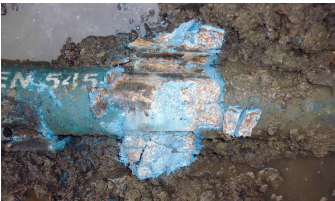
Obrázek 4.22: Zobrazení místa s poškozenou izolací po roce korozního namáhání
