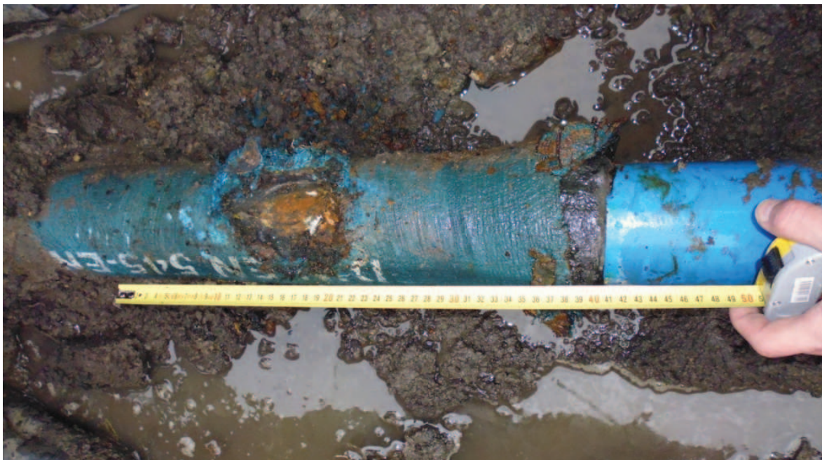
Obrázek 4.21: Zobrazení místa s poškozenou izolací po roce korozního namáhání
