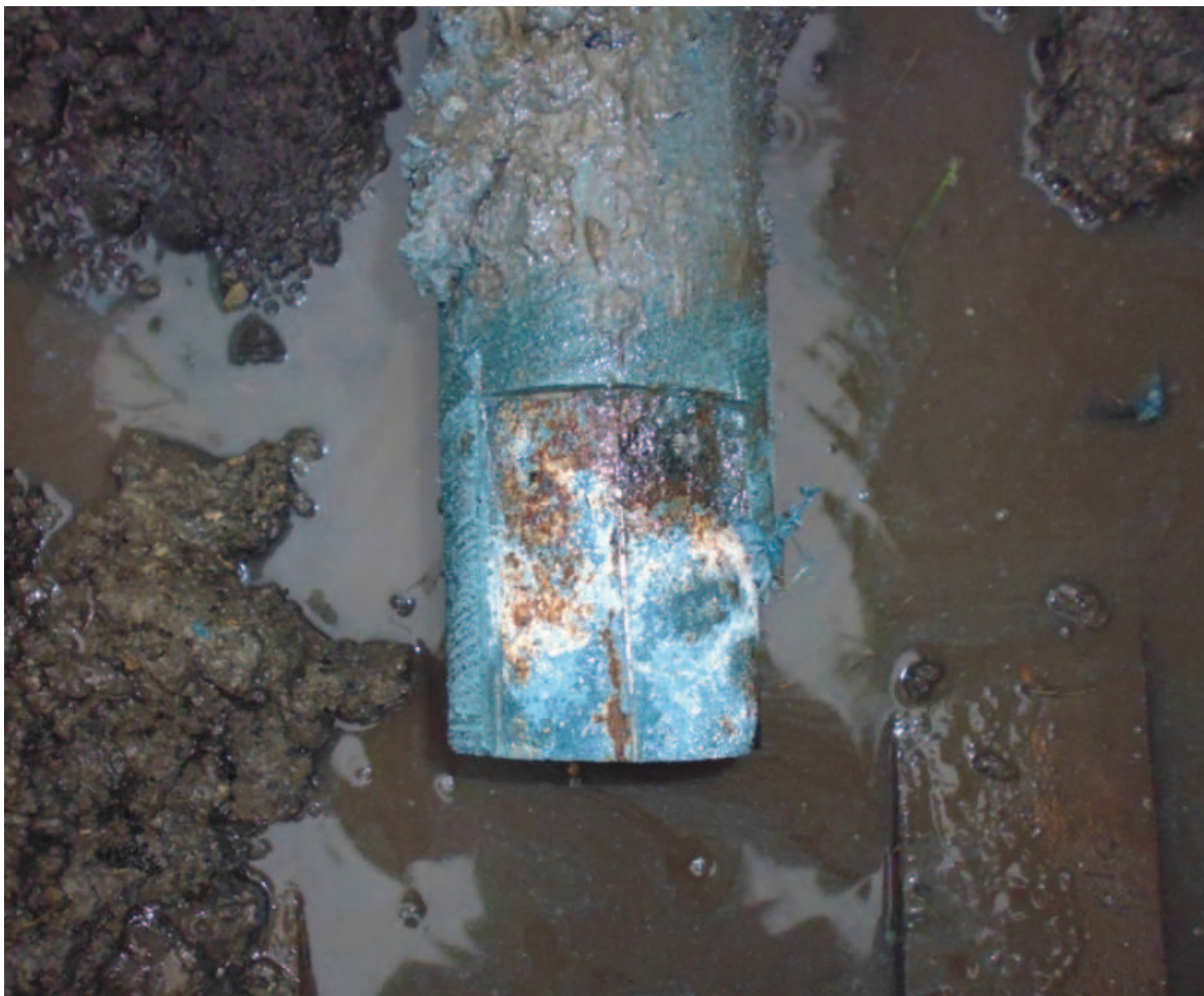
Obrázek 4.23: Zobrazení místa s poškozenou izolací po roce korozního namáhání
