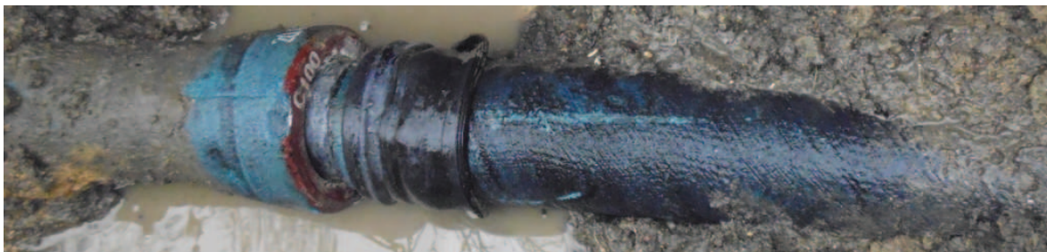
Obrázek 4.17: Zobrazení hrdlového spoje chráněného gumovou manžetou po roce korozního namáhání
