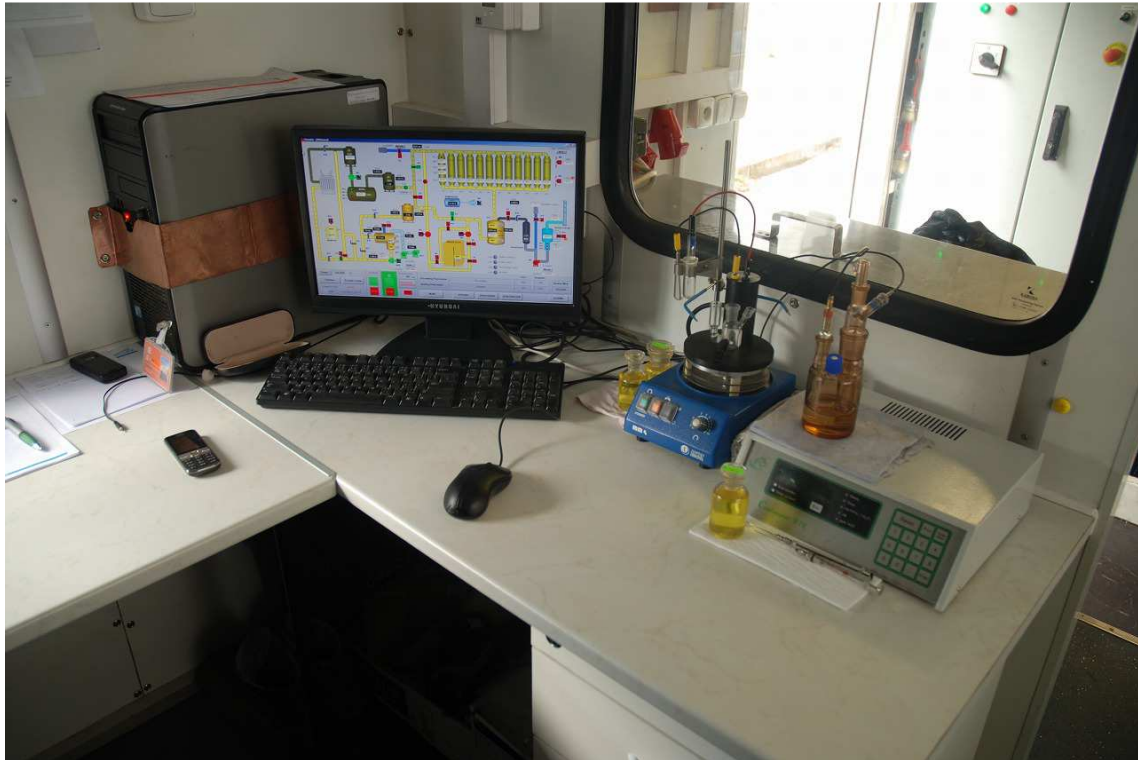
Obrázek 10: Řídící a kontrolní pracoviště regenerační stanice
