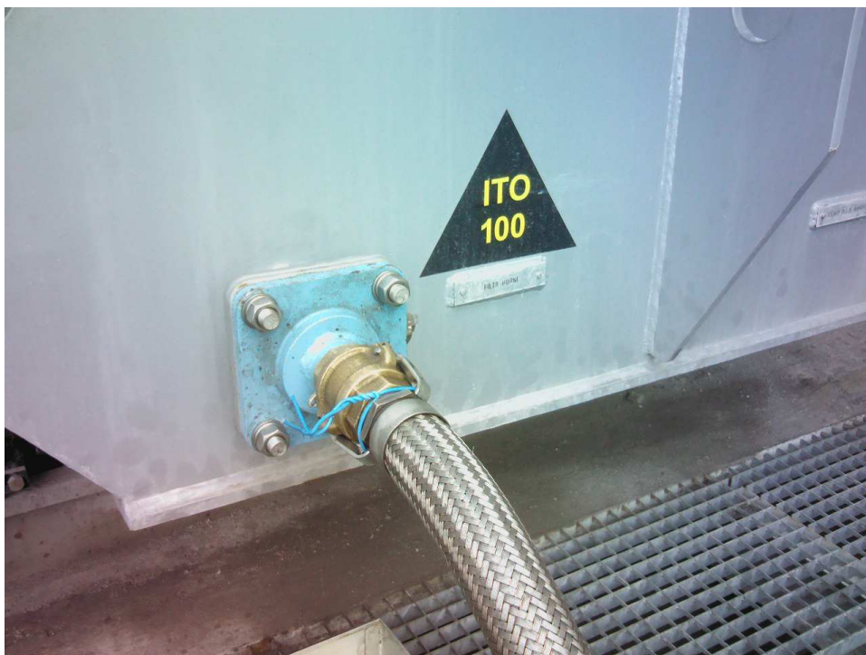
Obrázek 1: Označení použitého typu oleje u výpusti transformátoru
