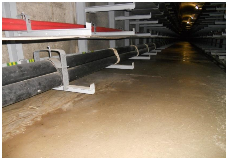
Obr. 3: Kably uložené v kolektorech
