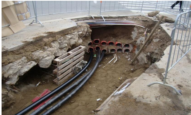
Obr. 2: Kably uložené v chráničkách
