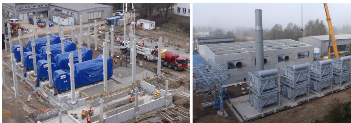
Obrázek 2: Všechny čtyři motorgenerátory umístěné na základových deskách (vlevo) a pohled na strojovnu s motorgenerátory přes spalínové kotle (vpravo).
