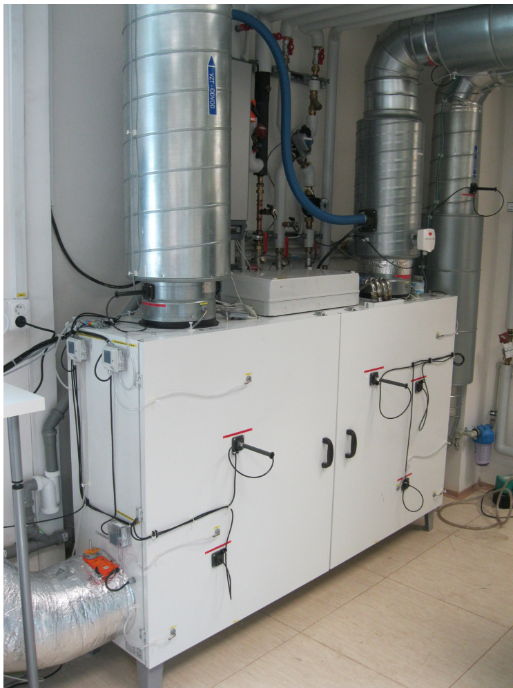
Obrázek C.1.: Pohled a experimentální HVAC jednotku
