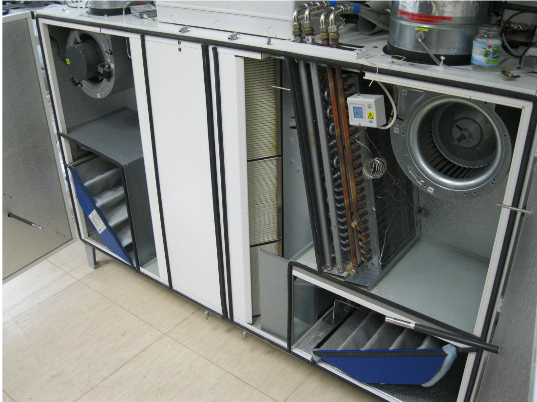
Obrázek C.3.: Otevřená HVAC jednotka
