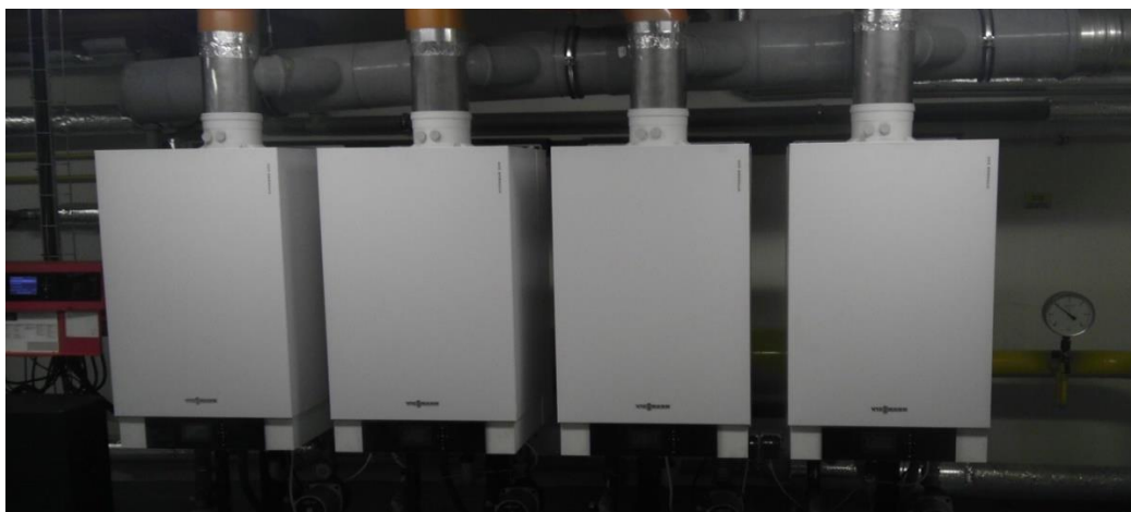
Obrázek 4: 4x kondenzační kotel Viessmann.
