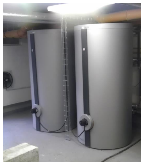
Obrázek 3: 2x1000l boiler na ohřev TUV.
