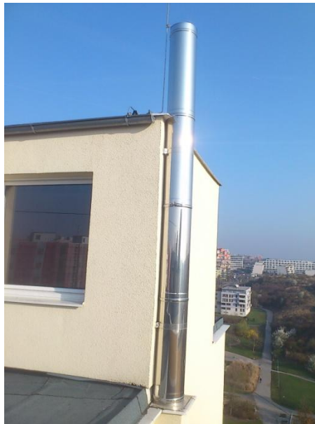
Obr. 15: Vyústění komínu se spalinami na bývalé strojovně výtahu. Zdroj [foto Ing. Vitek]
