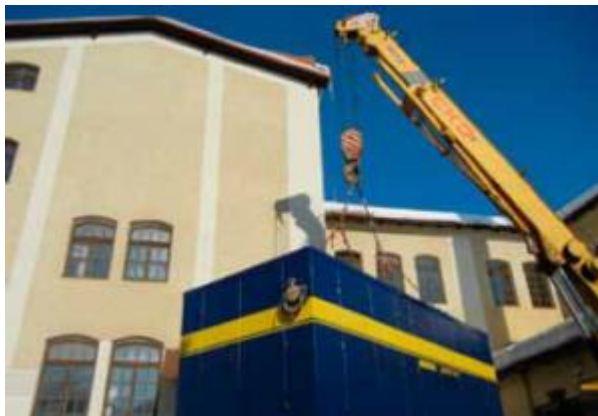
Obrázek 6 - Instalace KGJ v areálu AZ [41]
