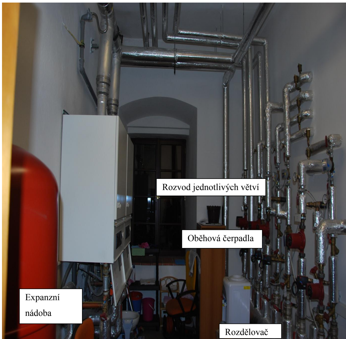
Obrázek 9: Kotelna, rozvod otopné vody
