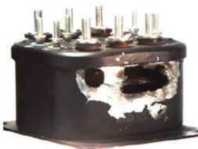
Obr. 4.7 Destrukce relé vyvolána vznikem elektrického oblouku.
