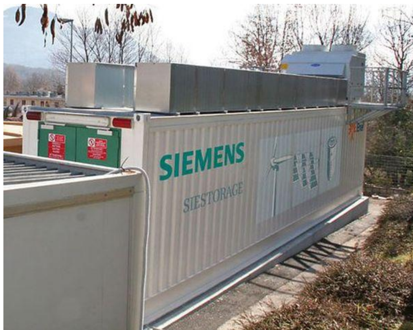
Obrázek 2: Velkokapacitní Lithium-Ion akumulátor Siemens Siestorage
