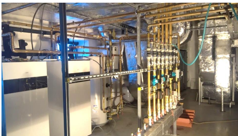
Obr. 2-11 Technická místnost s tepelnými čerpadly IVT, Petrova bouda [24]
