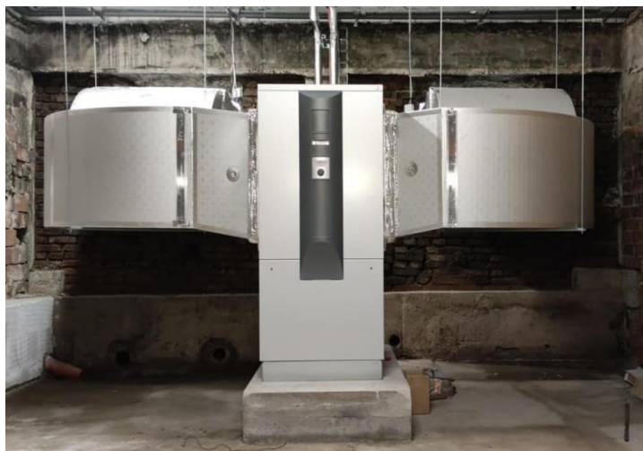
Obr 2-10 Tepelné čerpadlo alpha innotec LW 251, Luční bouda [21]
