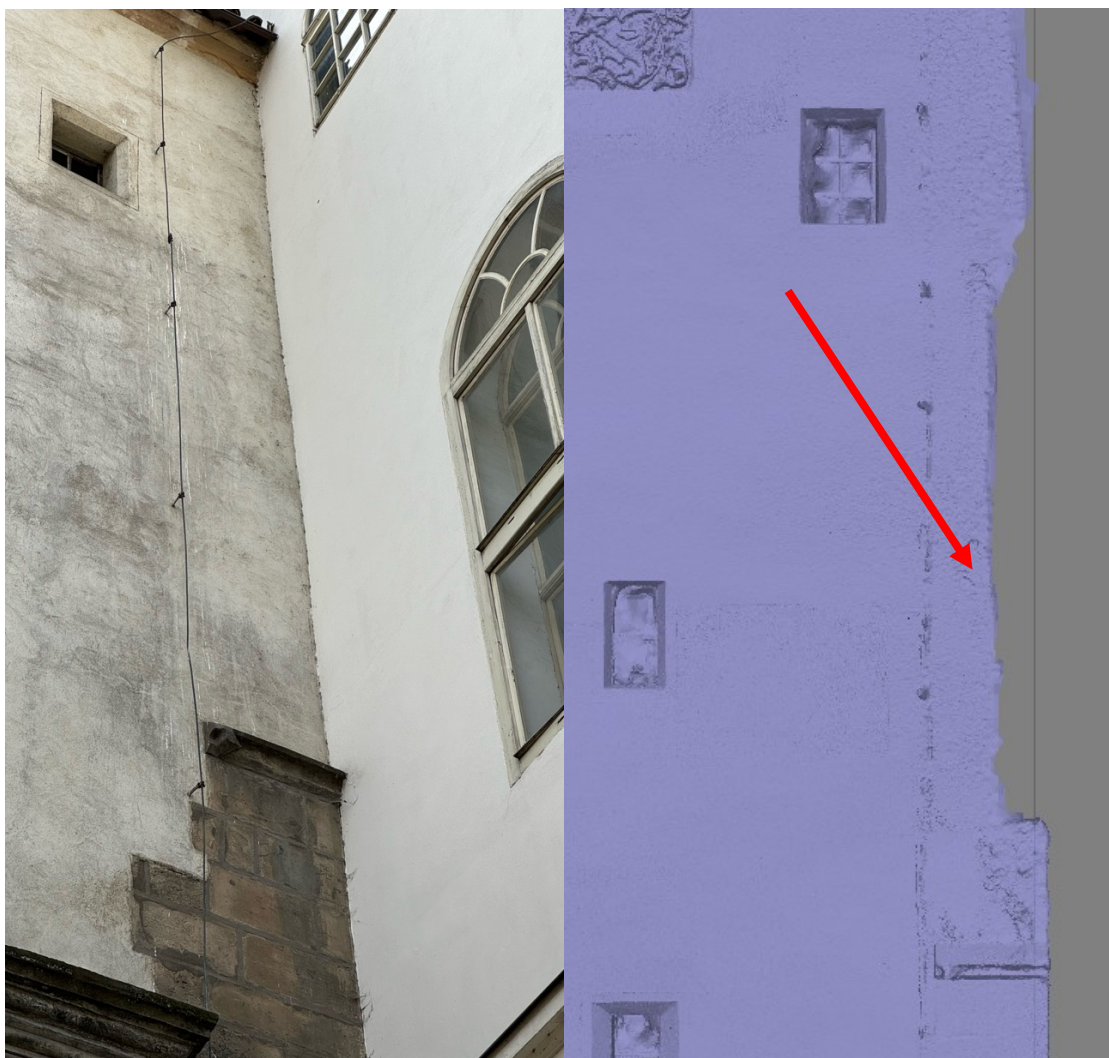
Obrázek 47 - Ukázka reálného stavu části objektu a chyby v modelu
