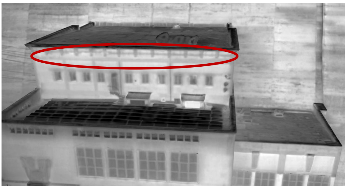
Obr. 17 - Úniky teplot v budově elektrárny [vlastní zdroj]
