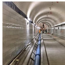
Obrázek 106: Ocelové vodovodní potrubí DN 300 [41]
