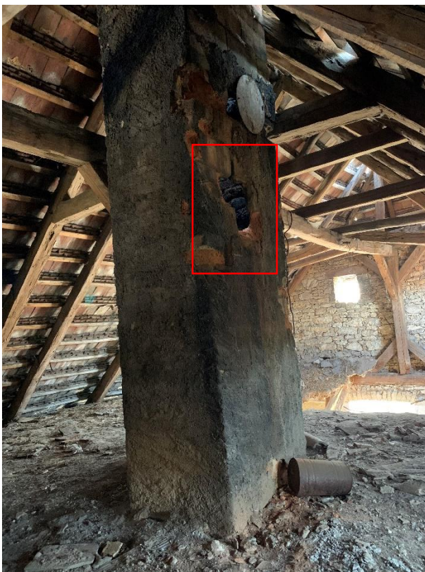
Obrázek 52: Narušení pláště komínového tělesa
