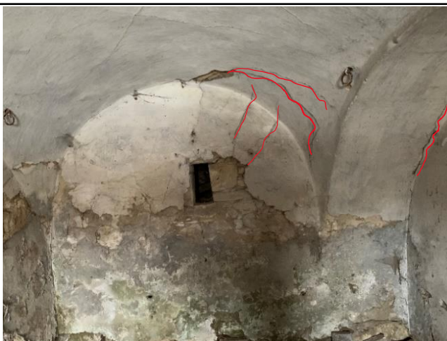
Obrázek 40: Skupina trhlin v zadní části chlívků 1.NP
