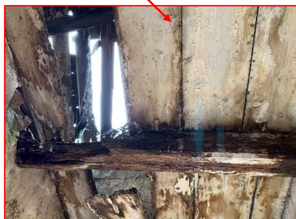
Obrázek 56: Hnilobou napadený strop předsíně přístavku
