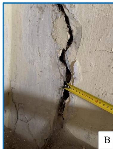
Obrázek 25: Svislá trhlina – vnitřní schodiště – B
