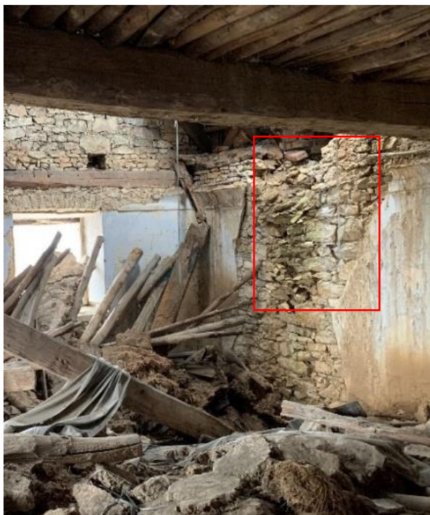
Obrázek 29: Porušení zdiva v místě uložení trámu
