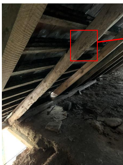
Obrázek 46: Podkroví – otvor u schodiště
