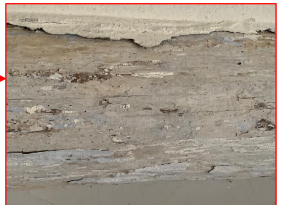
Obrázek 45: Výletové otvory od červotoče – trám stropu 2.NP
