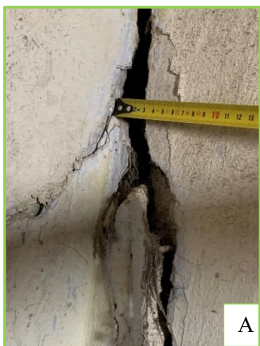
Obrázek 24: Svislá trhlina – vnitřní schodiště – A
