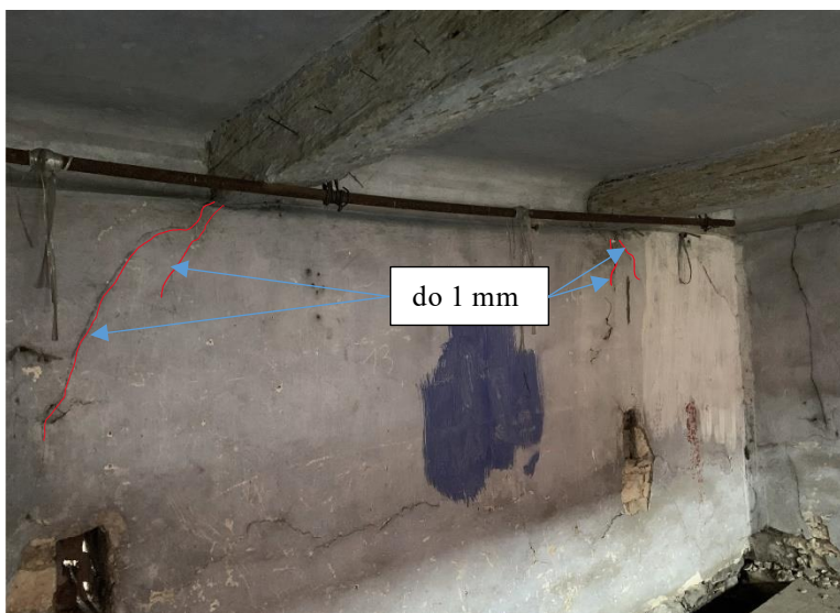
Obrázek 35: Trhliny kolem trámu 2.NP
