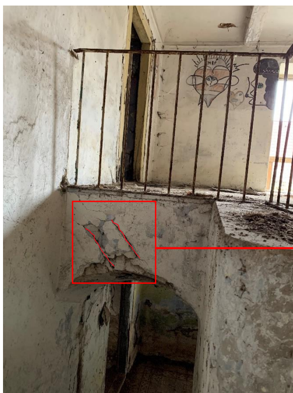
Obrázek 41: Trhliny v zaklenutí – pohled z prostoru schodiště
