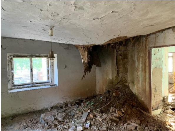
Obrázek 36: Porušení stropu obytné místnosti 1.NP
