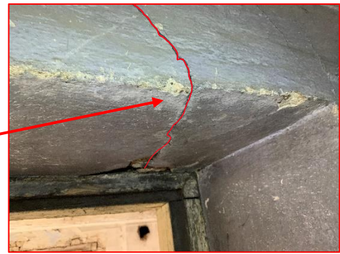
Obrázek 32: Detail trhliny nad otvorem ve 2.NP
