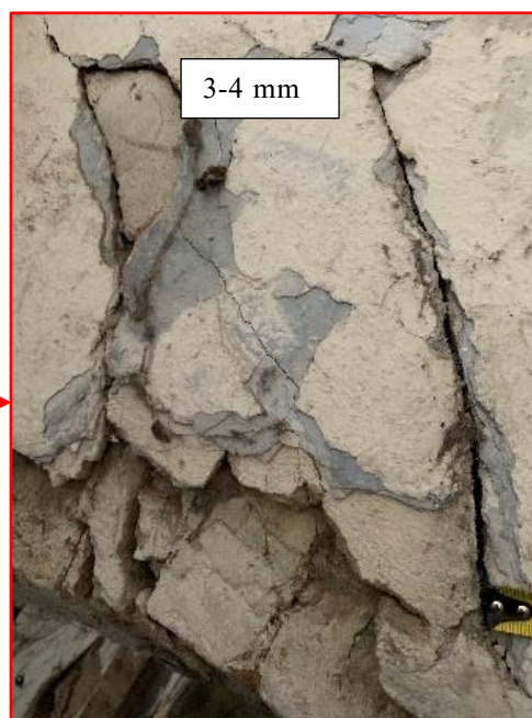
Obrázek 42: Trhliny v zaklenutém nadpraží u schodiště
