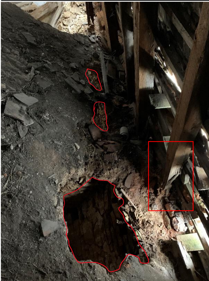
Obrázek 53: Narušené krokve počínající hnilobou, lokální propad stropu
