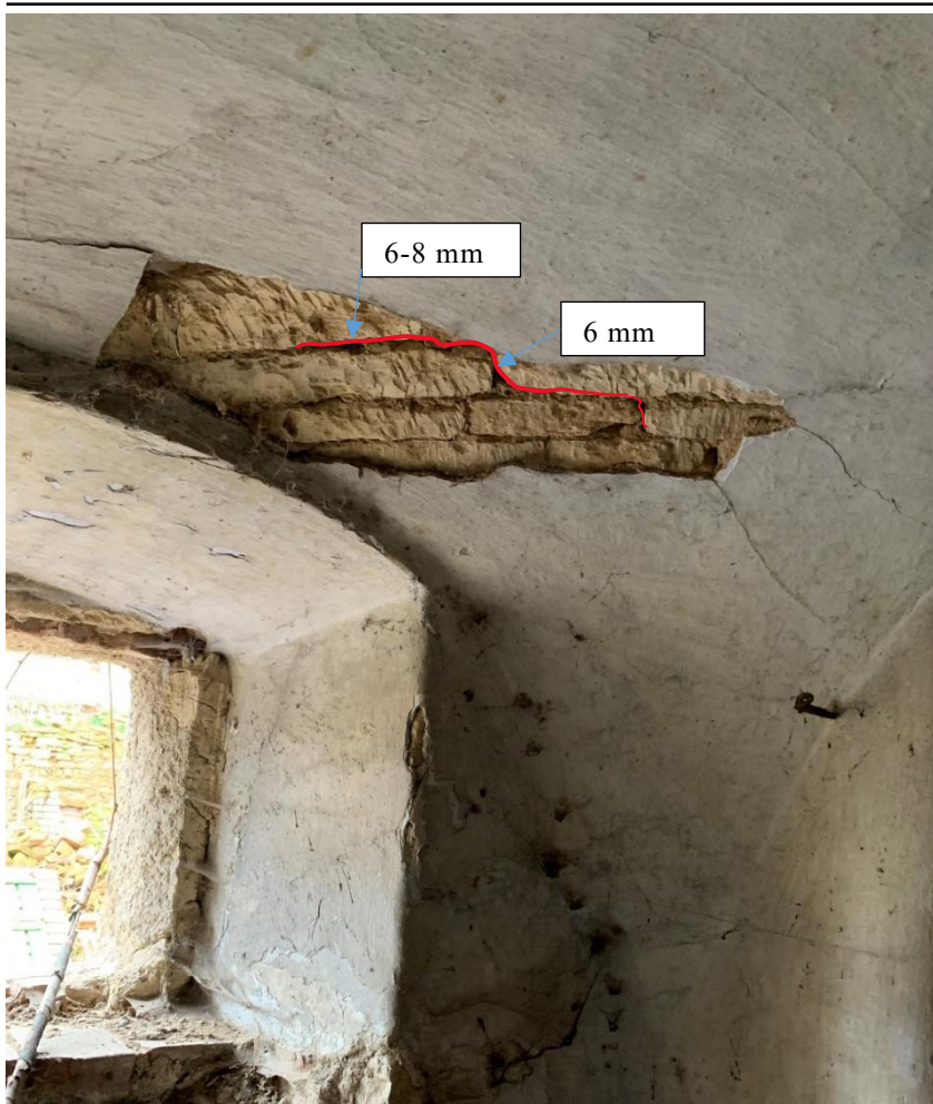
Obrázek 61: Trhliny v pruské klenbě u vchodu do chlívků
