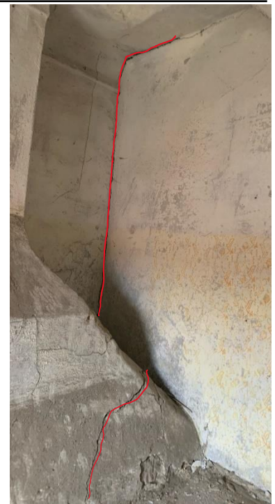
Obrázek 28: Detail trhliny kolem komínového tělesa 2.NP
