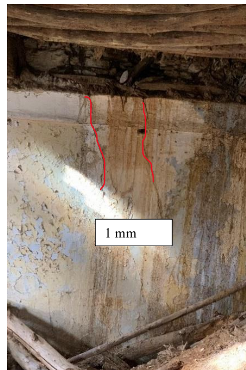
Obrázek 30: Šikmé trhliny v místě původního podbití stropu 2.NP
