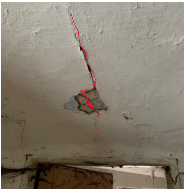
Obrázek 38: Trhlina ve vrcholu klenby nad chodbou 1.NP
