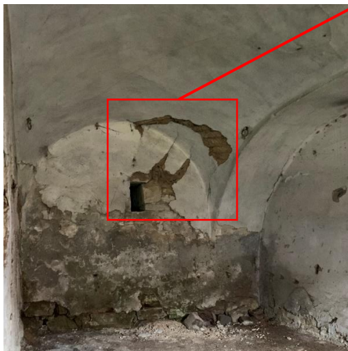
Obrázek 60: Prostor chůvku – trhlina v pruské klenbě
