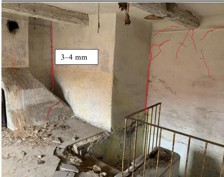
Obrázek 27: Trhliny kolem komínového tělesa 2.NP
