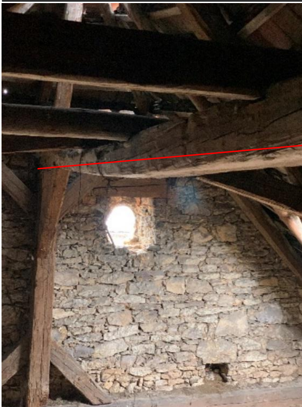
Obrázek 50: Zvýšený průhyb vazného trámu
