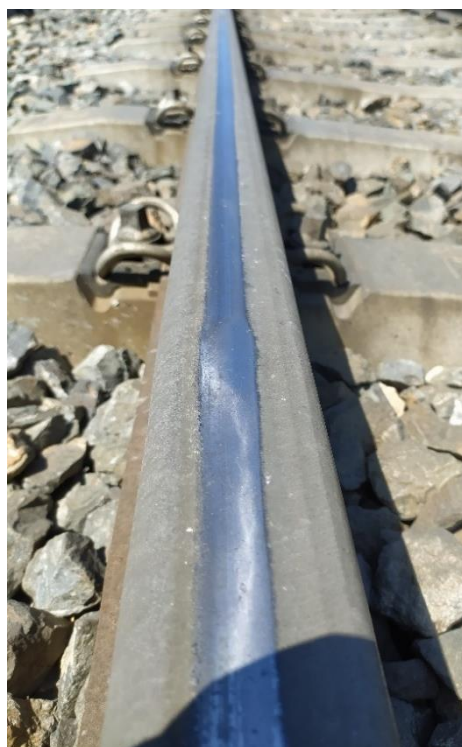
Obr. 76 - Detail pojížděné plochy kolejnice [Zdroj: Autor]
