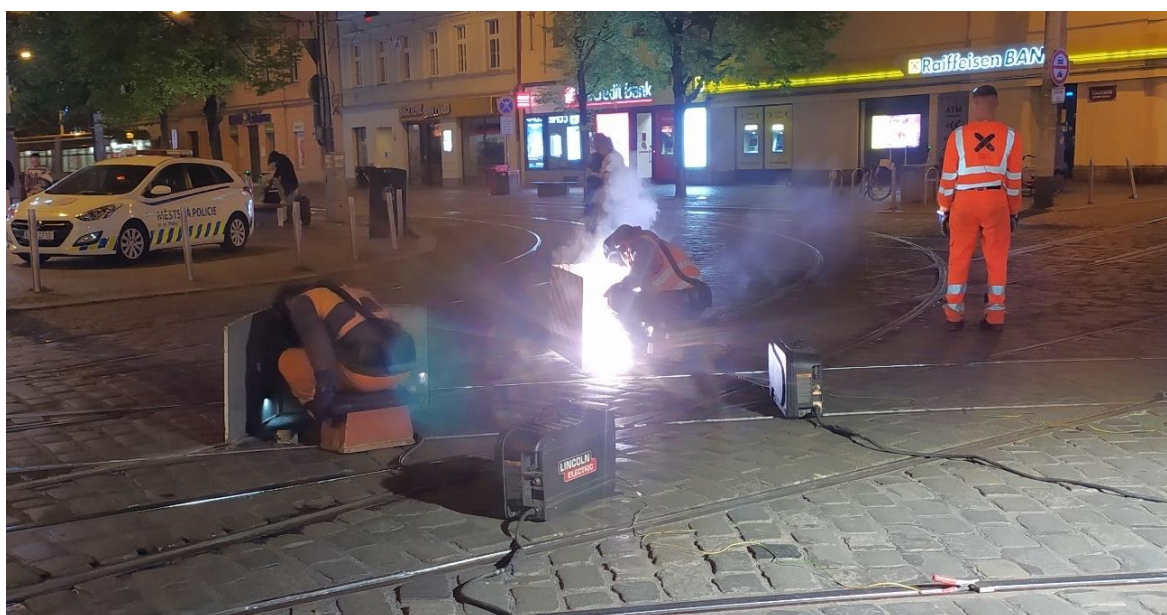
Obr. 68 - Provádění návaru žlábků svářeči Pražské strojírny a.s. na tramvajové křižovatce Anděl [Zdroj: Autor]
