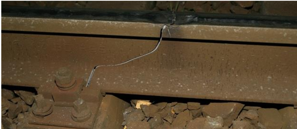
Obr. 12 - Lom kolejnice Rosice nad Labem 17. listopadu 2011 [16]
