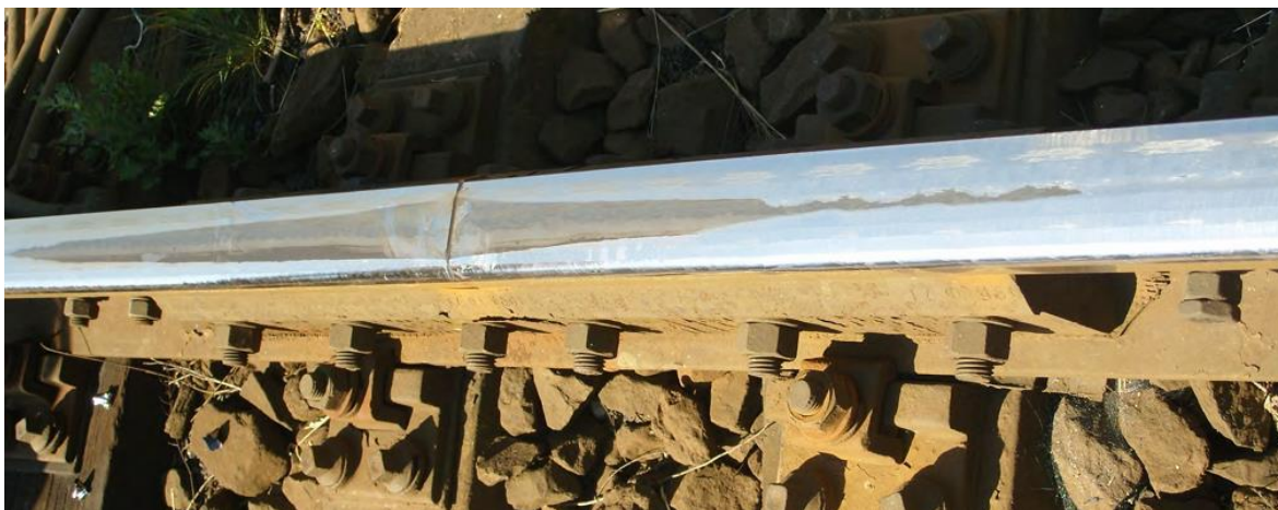
Obr. 2 - Propadlý kolejnicový styk po opravě přebroušením [5]
