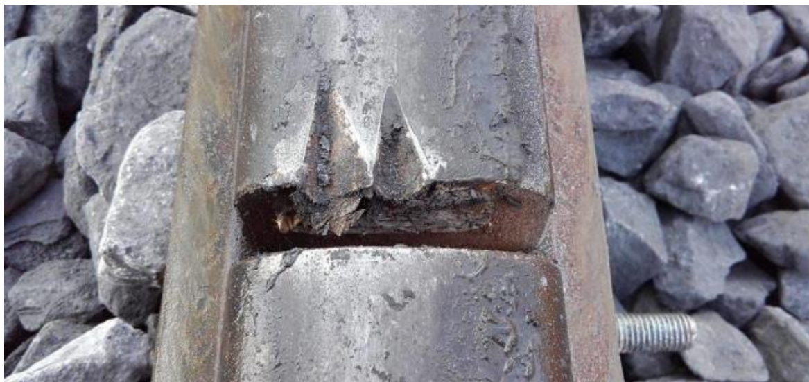
Obr. 40 - Vrypy na temeni kolejnice v místě konců kolejnic [40]
