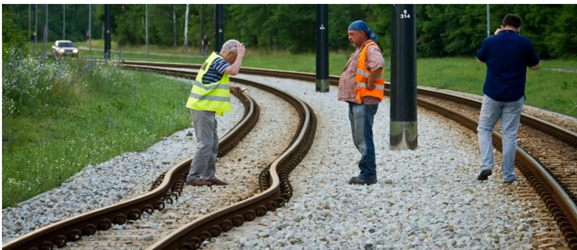
Obr. 14 - Vybočení kolejového roštu ve vodorovné rovině [19]
