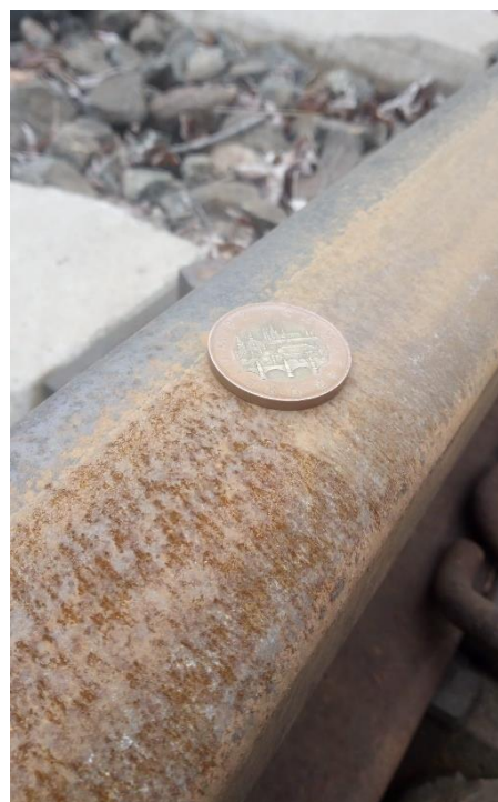
Obr. 78 - Detail pojížděné plochy kolejnice [Zdroj: Autor]
