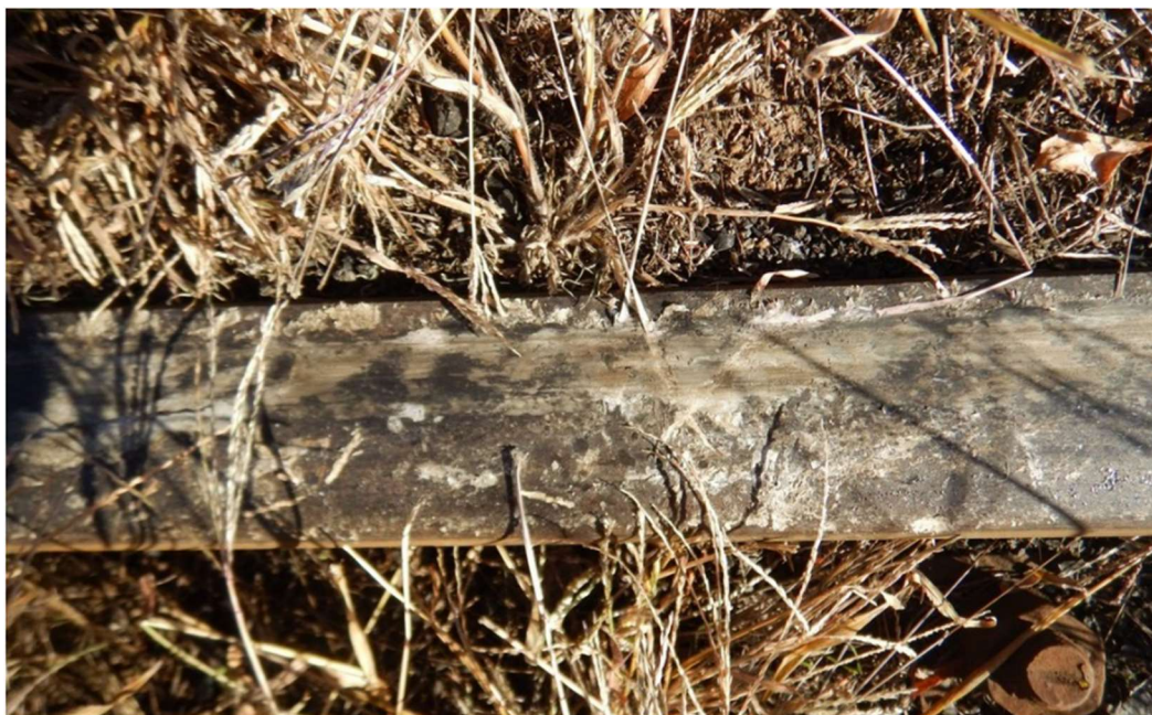
Obr. č. 3: Detail stavu temene hlavy kolejnicového pásu [10]
