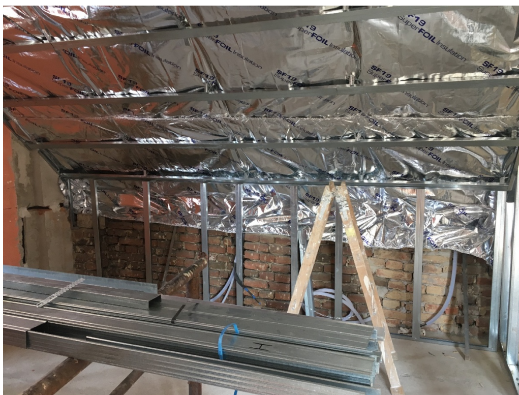
Obrázek 36: Vytvoření vzduchové mezery pod izolantem pomocí UV profilů. Zdroj: interní podklady firmy SuperFOIL.
