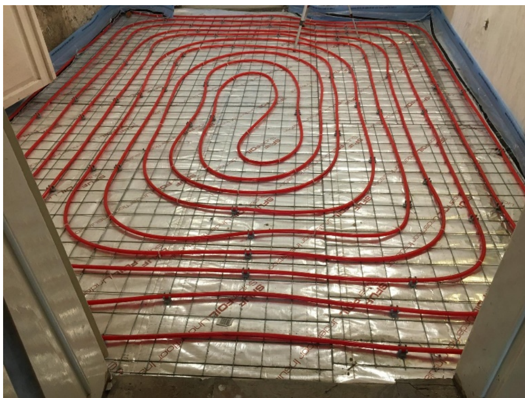
Obrázek 47: Realizace reflexní tepelné izolace pod podlahové vytápění. Zdroj: interní podklady firmy SuperFOIL.
