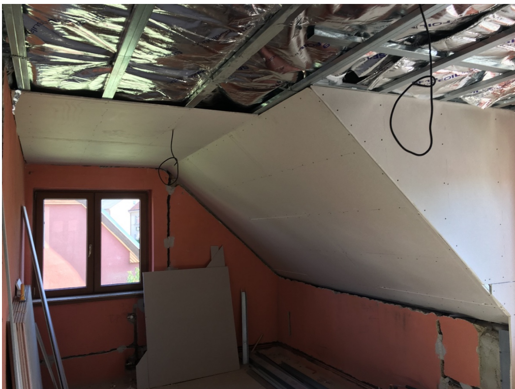
Obrázek 35: Vytvoření vzduchové mezery pod izolantem pomocí UV profilů. Zdroj: interní podklady firmy SuperFOIL.
