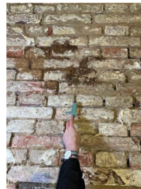
Biokoroze na klenbě v lednici
