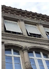
Obr. 53 - výklopné rolety nádraží, Strasbourg-Ville, zdroj: vlastní, 2023
