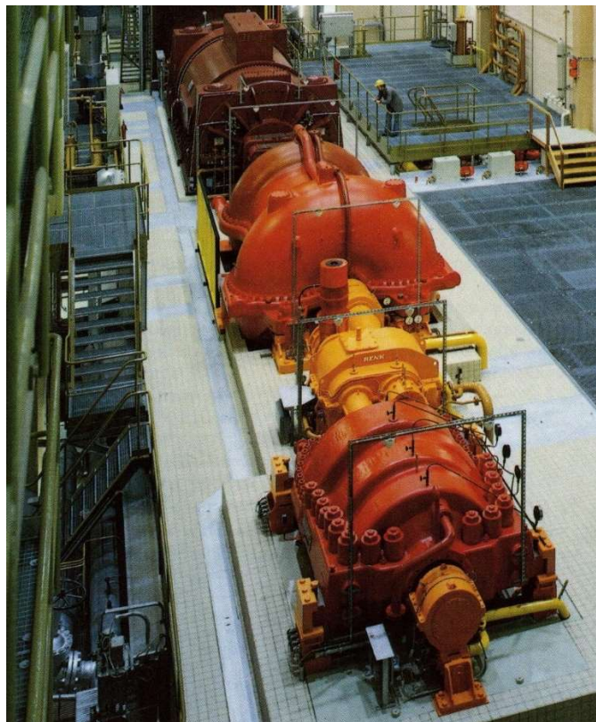
Obrázek 44: Pohled do strojovny CAES elektrárny Huntorf, převzato z [44]
