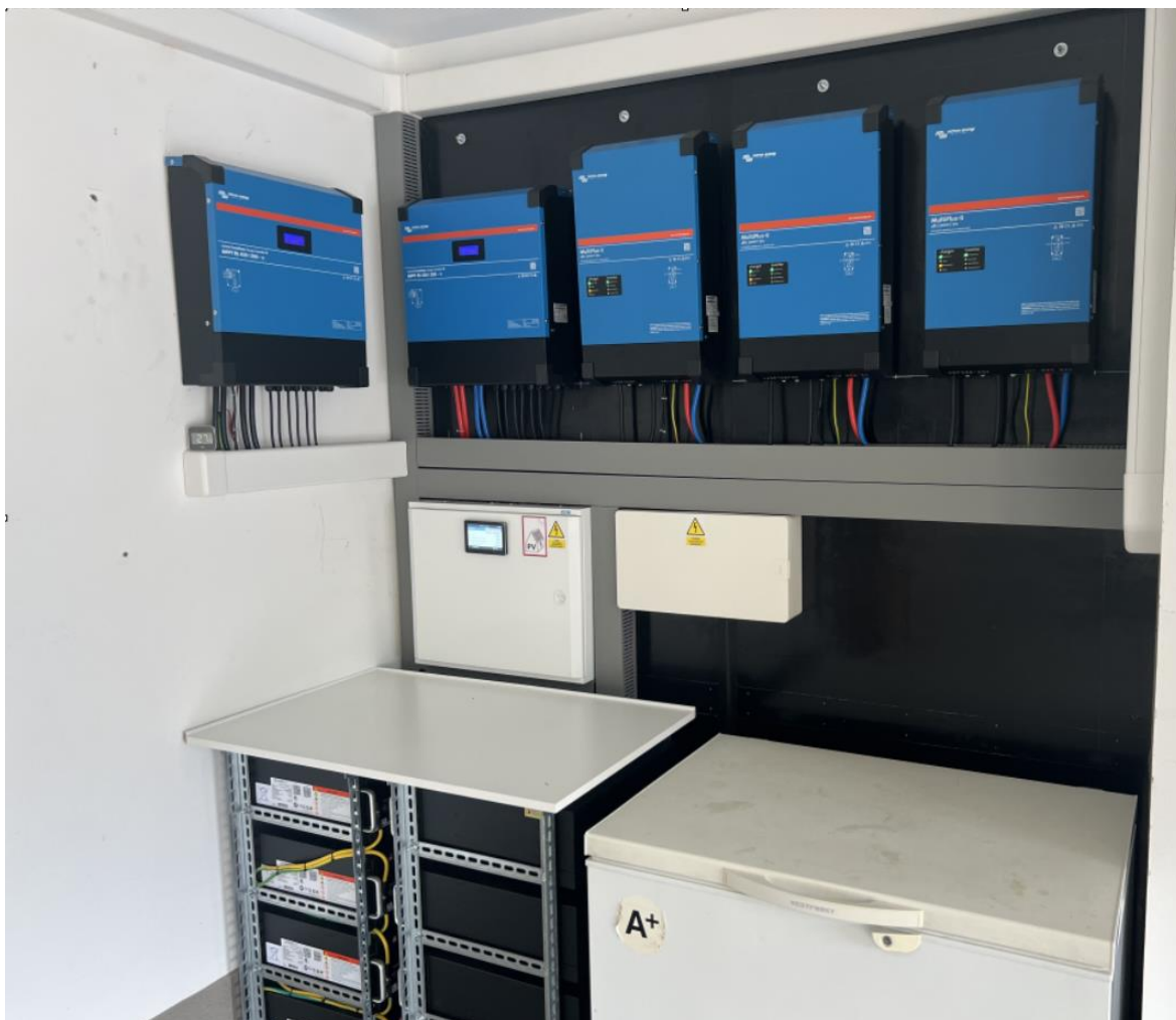
Obr. 8 Střídače FVE a baterie
