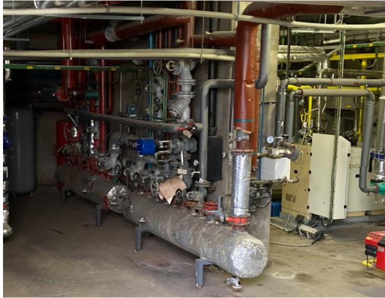
Obrázek 2.1.2 Rozvaděč a sběrač topné vody v kotelně
