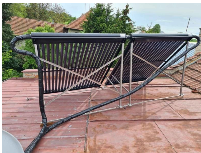
Obrázek 3.3.1 Kolektor AAA Sol-20T na ploché střeše [12]
