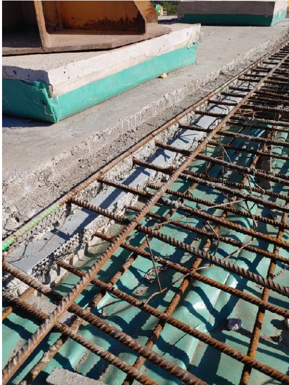
Obrázek 11: Pracovní spára v základové desce s vodonepropustnými vlastnostmi [12]
