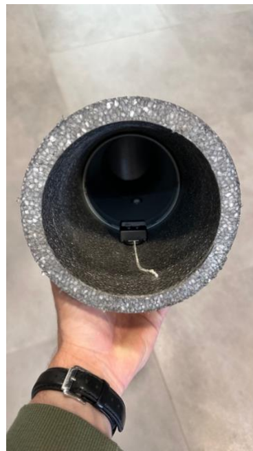
Obrázek 18 Umístění měřicího zařízení na straně odvodu
