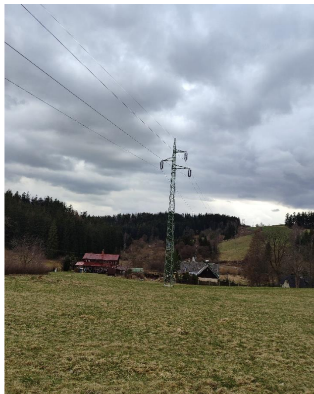
Obr. č. 77: Vedení VVN 110 kV na severu obce
