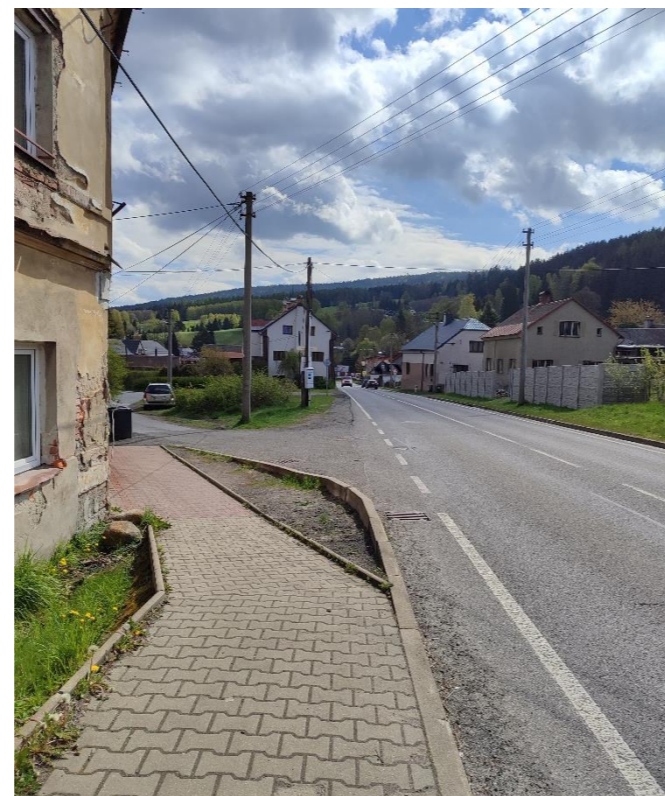
Obr. č. 78: Nadzemní vedení nízkého napětí u I/14
