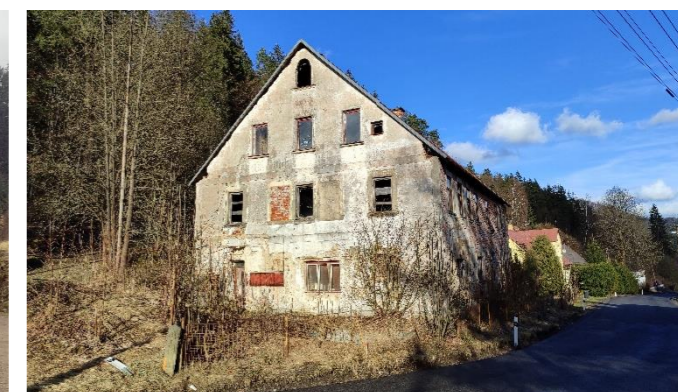
Obr. č. 119: B6 – zchátralý objekt u silnice III/29041
