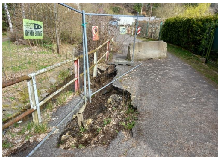
Obr. č. 120: SV1 – probořená místní komunikace
