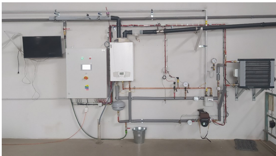
Obr. 18: Demonstrační decentralizovaná jednotka
