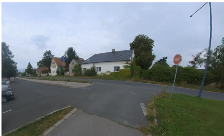
Obrázek 42: Opotřebované VDZ V 2b (V 8a) v místě křížení cyklistické trasy 2 a výjezdu z parkoviště v ulici Kostomlátecká [22]
