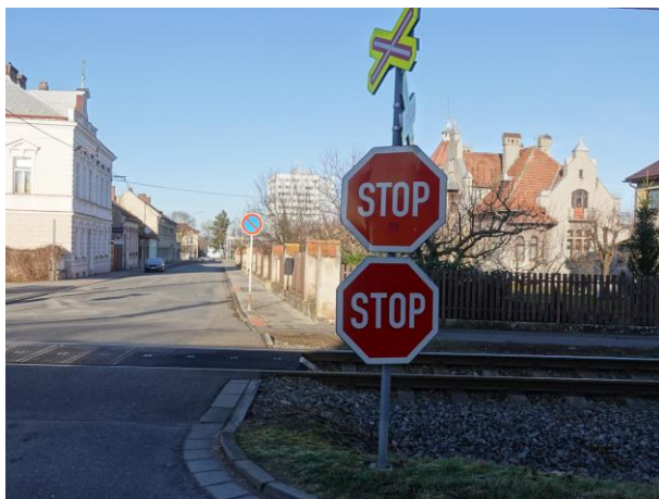
Obrázek 162 – Chybné nasměrování SDZ P 6 před železničním přejezdem
