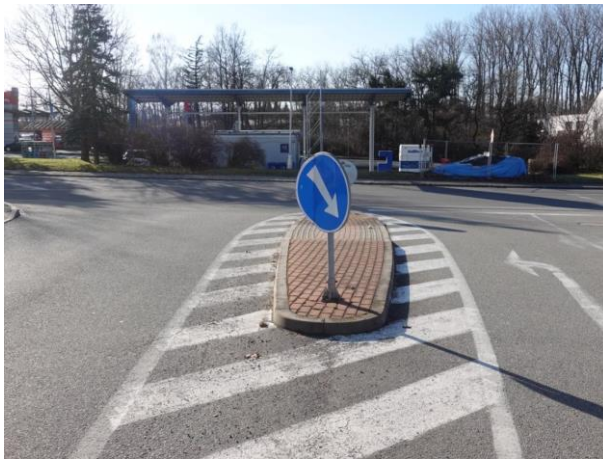
Obrázek 205 – Poškozené SDZ na ochranném ostrůvku
