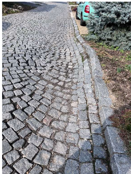
Obrázek 15 deformovaná dlážděná komunikace v ulici Příčná I. [foto autor]
