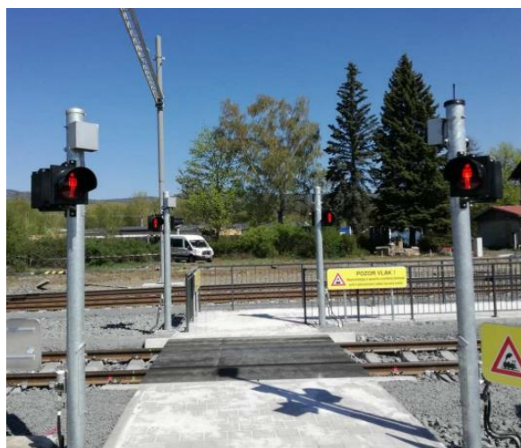
Obrázek 4: VZPK, výstražné zařízení pro přechod kolejí, nikoliv železniční přejezd [43]
