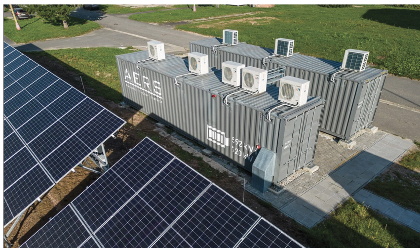
Obrázek 3.8: Instalované čtyřicetistopé kontejnery vedle fotovoltaické elektrárny. Zadní je čistě bateriový. [87]
