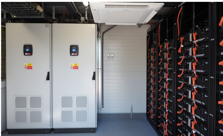
Obrázek 3.2: Interiér přístavku s bateriemi (vpravo) a skříněmi obsahující jejich střídače. [78]
