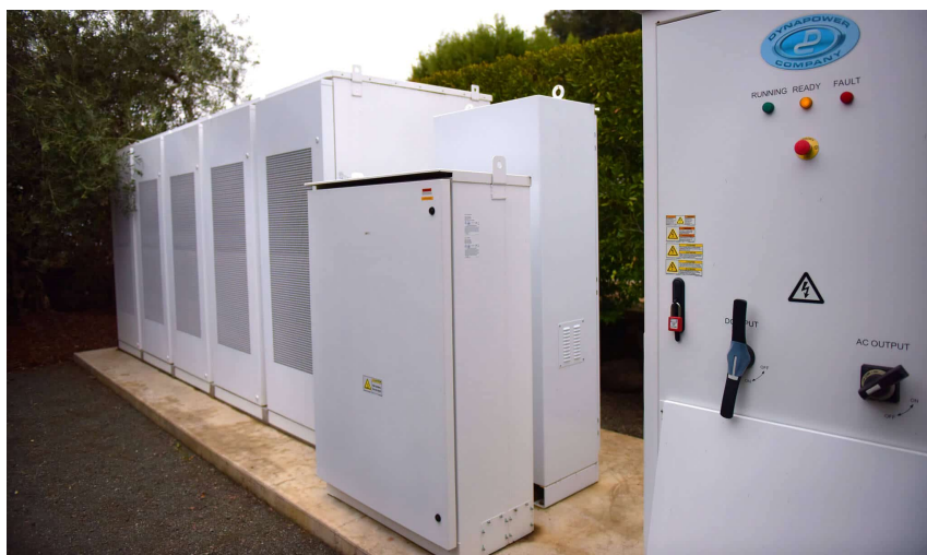
Obrázek 4.13: Bateriové úložiště Tesla Powerpack s měničem Dynapower. [126]
