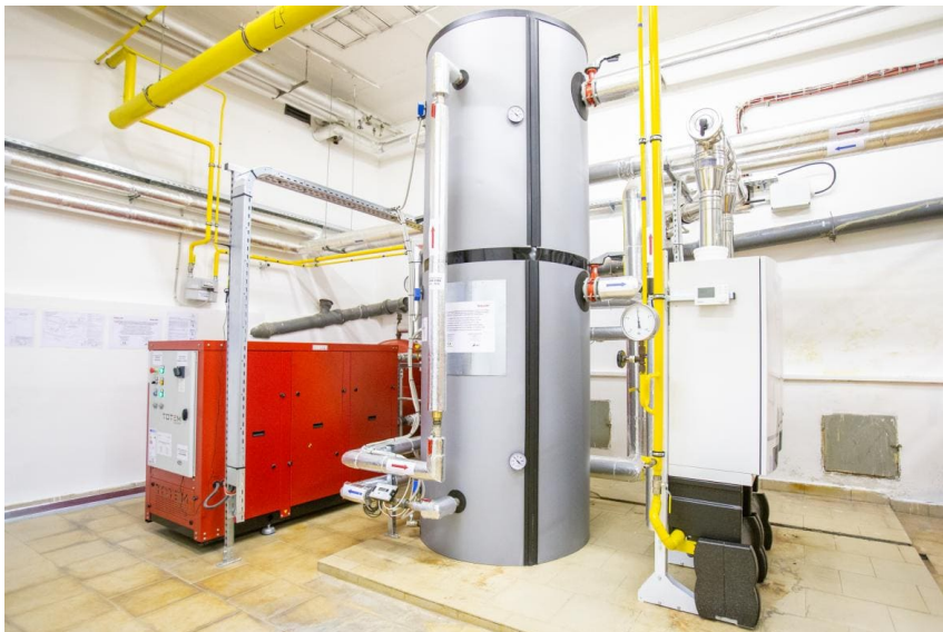
Obrázek 3.15: Kotelna v objektu základní školy. Zleva: kogenerační jednotka TOTEM, akumulací nádoba, plynové kondenzační kotle. [98]
