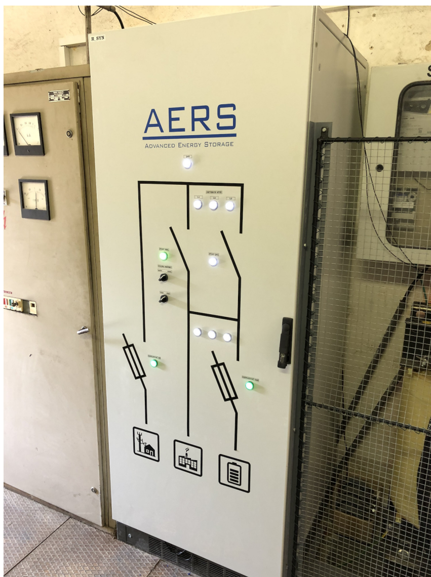
Obrázek 3.5: Skříň v hlavní rozvodně, kde dochází k připojování bateriového úložiště do rozvodné sítě areálu. Vpravo je zčásti vidět transformátor pro galvanické oddělení. [83]
