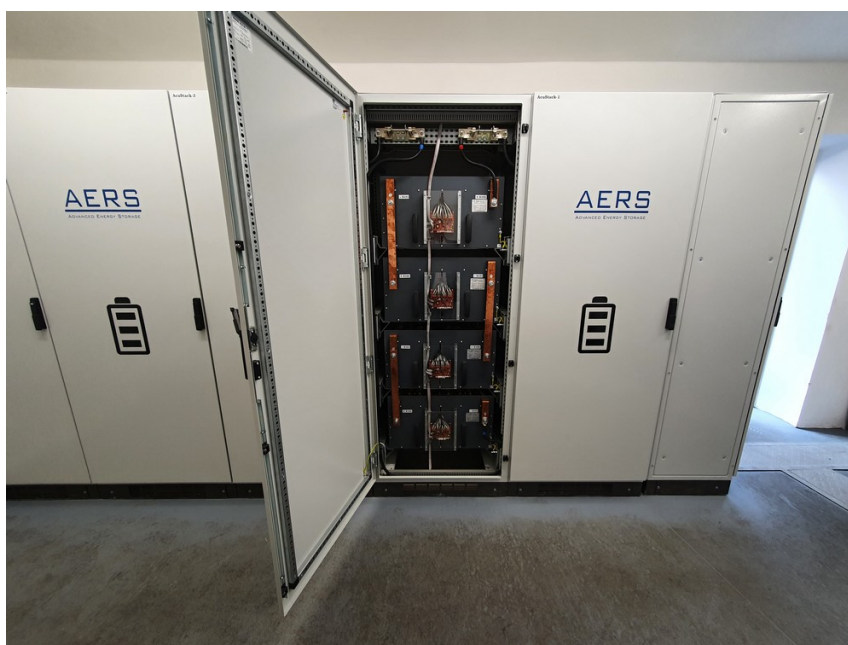
Obrázek 3.4: Jedna ze skříní s bateriovými packy, patrné jsou silové propoje měděnými šínami na bocích a monitorovací jednotky na přední straně. [82]
