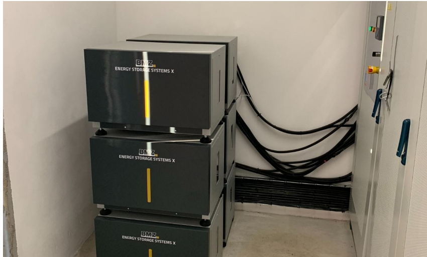
Obrázek 3.17: Místnost s rozvaděči a bateriovým úložištěm. [105]
