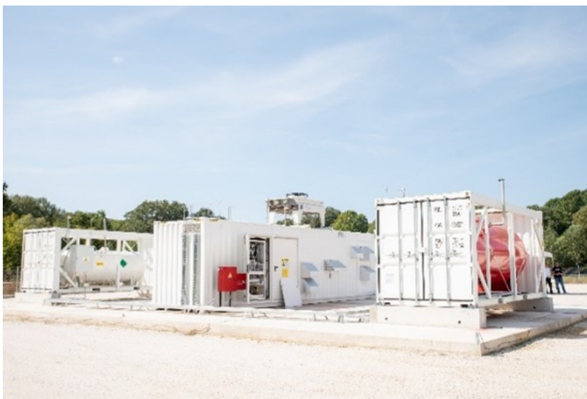
Obrázek 4.5: Vodíkový akumulční systém v kontejnerovém provedení. [115]
