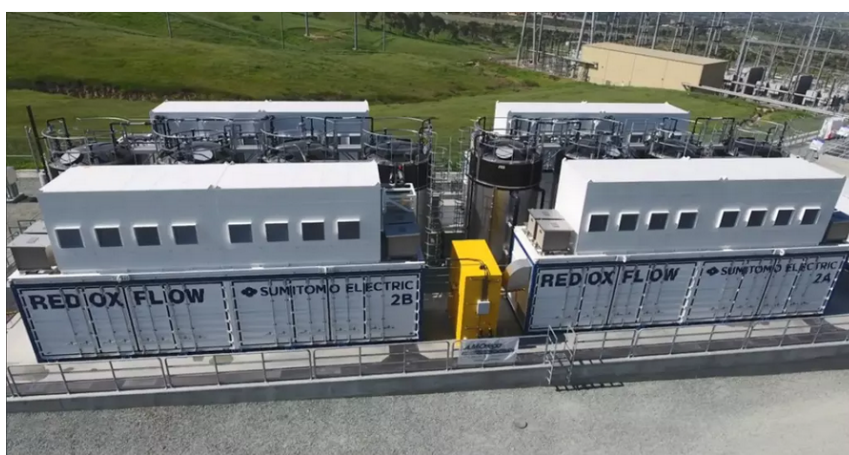
Obrázek 4.16: Průtočná baterie umístěná v areálu rozvodny. [131]
