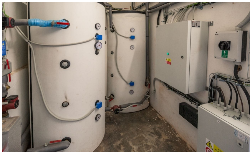
Obrázek 3.13: Dvě akumulční nádrže na teplou vodu, každá s objemem 1000 l. [97]
