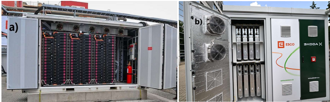
Obr. 2-8 (a) Pohled na bateriový kontejner s racky. Převzato z [66]. (b) BSAE realizované pro posílení distribuční sítě. Převzato z [67].
