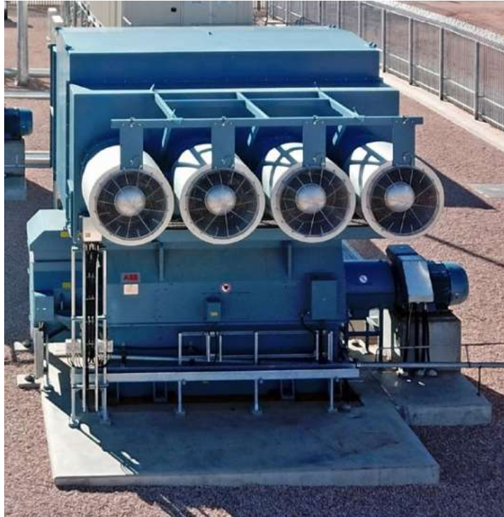
Obr. 42 Příklad instalace synchronní kompenzátoru v Jižním Walesu (Austrálie) [68]
