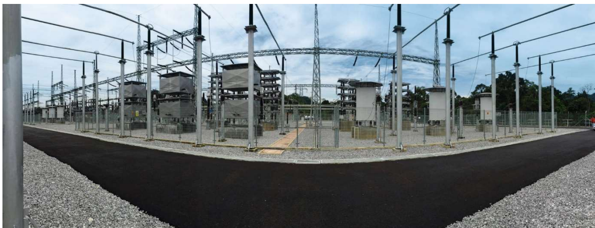
Obr. 35 Zobrazení instalace MSC v rozvodně v Malajsii [75]
