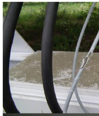
Obr. 16: Poškození izolace vodiče
