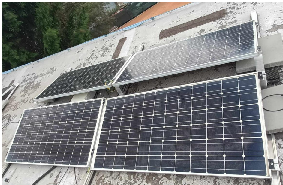
Obr. 39: Moduly na střeše Fakulty elektrotechnické
